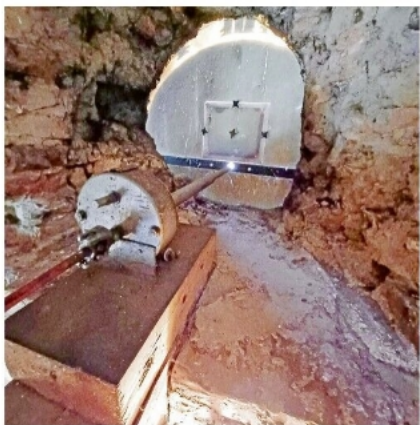
Faszinierende Einblicke in den Kirchturm. Die Kardanwelle (im Vordergrund) treibt das Zifferblatt der Uhr an, dessen Rückseite hier zu erkennen ist.
