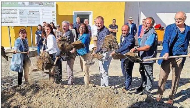
So sah es aus beim symbolischen Spatenstich Ende April: Rechts Architekt Rainer Wilhelm, dritter von rechts Bürgermeister Alexander Brot, links daneben Vorgänger Michael Böhm. Foto: Christian Tamm
